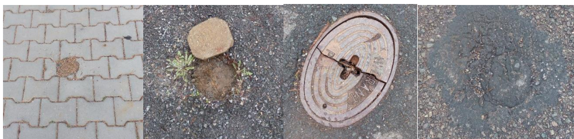
Obr. 1 Ukázka poruch na vodovodních prvcích
